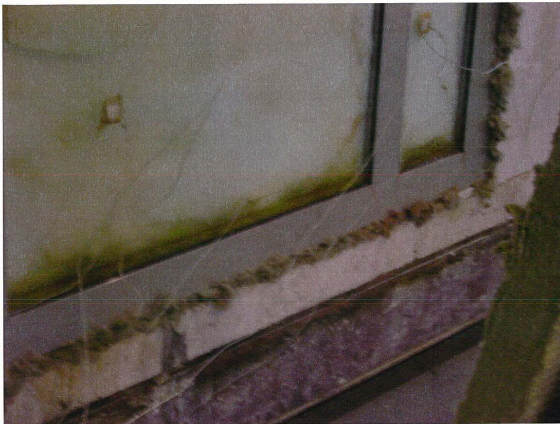
Foto 5 : aanzicht van de constructie na 21 minuten verhitting. Je ziet duidelijk condens vorming langs de ruiten en onderin de profielen
