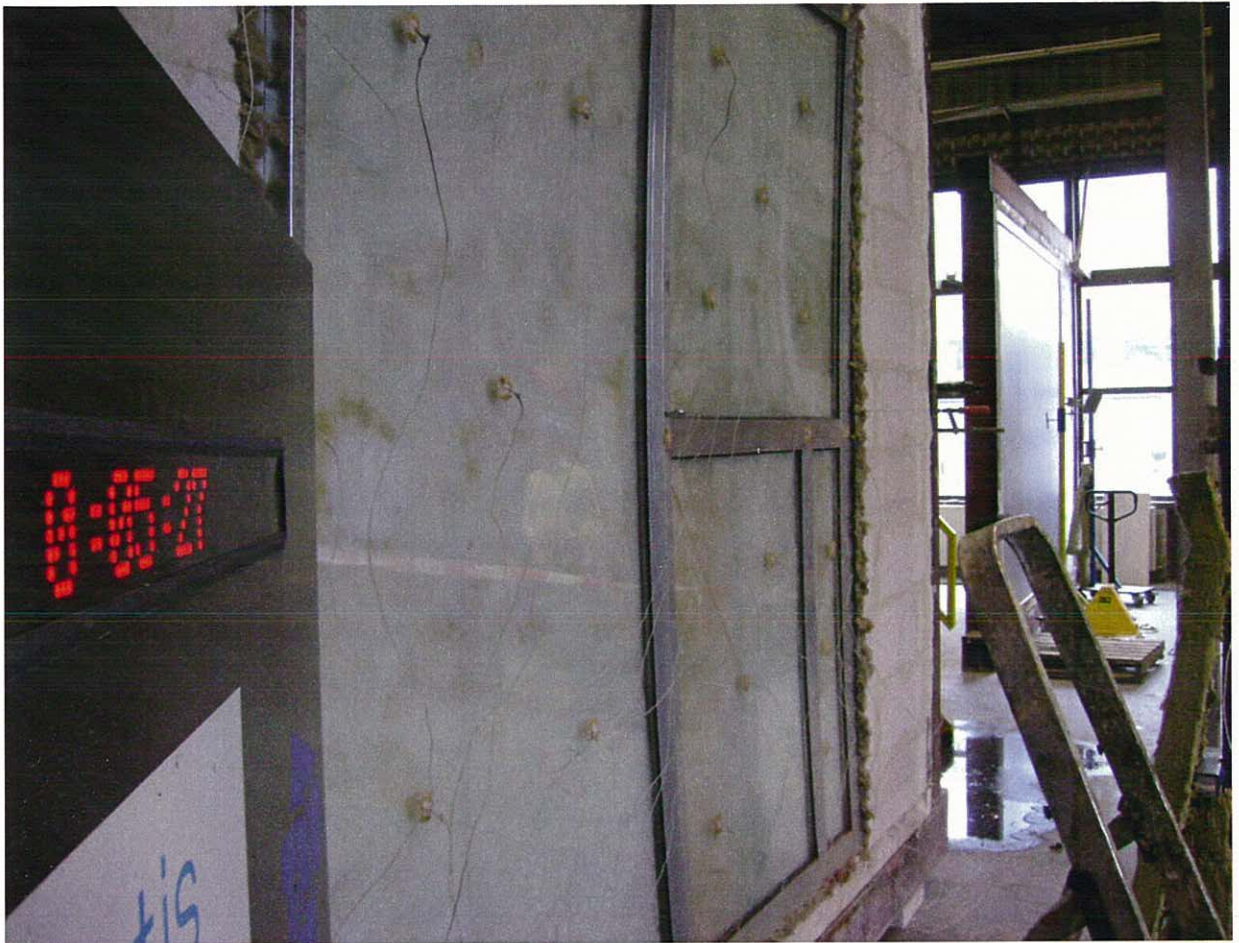
Foto 3 : aanzicht van de constructie na 5,5 minuten verhitting Je kunt goed zien dat het frame naar het vuur toe buigt.
